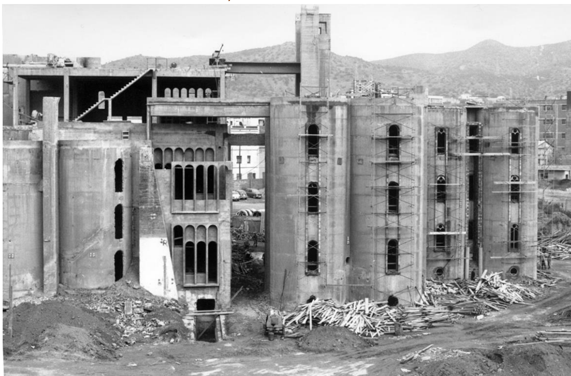
Figura 13. Fotografía donde se observa el proceso de apertura de las ventanas en los silos de la cementera, así como la construcción de la envolvente
