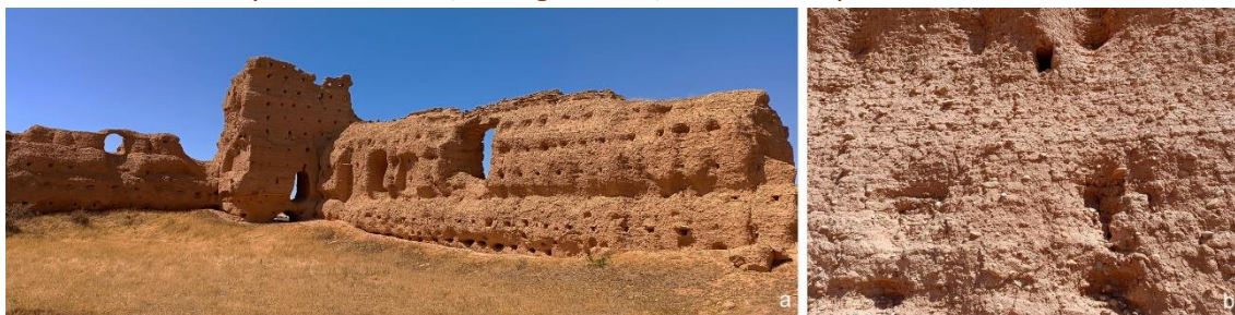
Figura 2. Castillo de Serón de Nágima (Soria, España). Construcción de tapial, s. XIII-XIV: a) Vista general; b) Detalle del tapial erosionado
