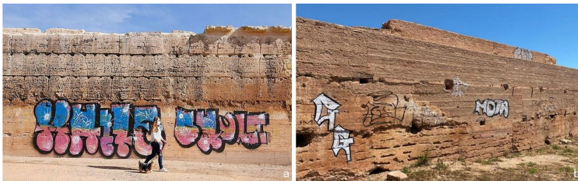
Figura 5. Graffitis realizados sobre tapial con revestimiento de tierra: a) Muralla en Ronda del Marrubial , s. XI (Córdoba); b) Castillo de Nules, s. X. La Vilavella (Castellón)
