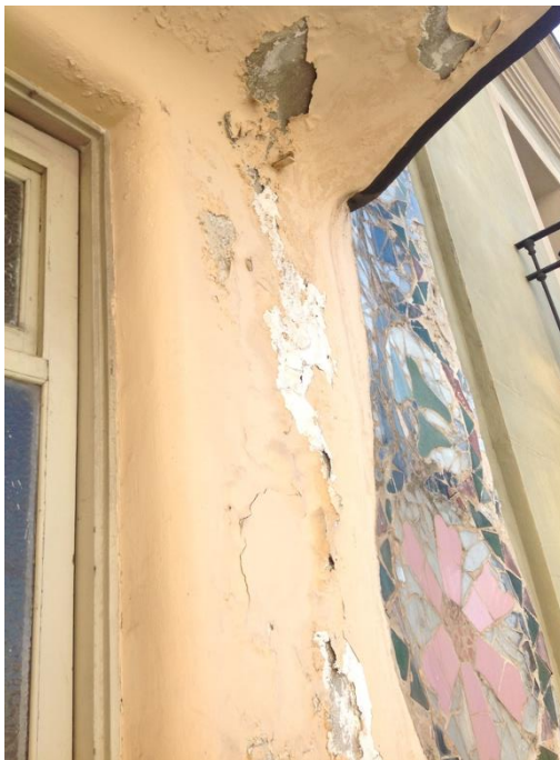
Figura 14. Degradación revestimiento fachada posterior
