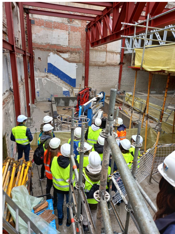
Fig. 5 Visita del alumnado a la obra de rehabilitación de equipamiento deportivo (Madrid). Grupo Ferroviario
