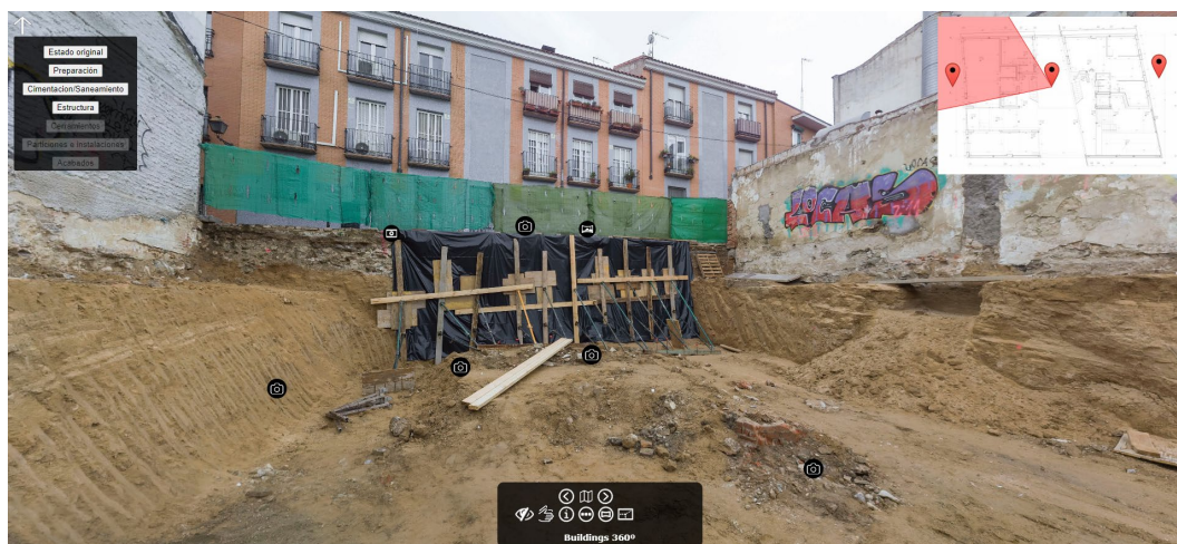
Fig. 1 Funcionamiento de la plataforma Buildings 360° sobre una de las obras registradas: interfaz general
