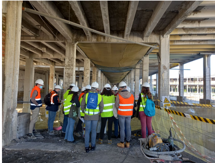
Fig. 4 Visita del alumnado a la obra de rehabilitación del Mercado de las Flores (Madrid). Grupo Ferroviario
