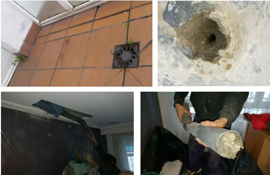
Fig. 1 Imágenes de la patología detectada. Fuente: Fotografías propias
