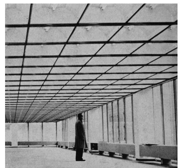
Fig. 11 Techo técnico de planta tipo del edificio
