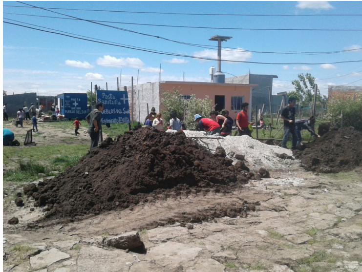
Fig. 14. Vecinos y militantes trabajando en la mejora de una Posta Sanitaria en el UNK. 2015. Fuente: dirigente social, Rodrigo Barrios de "El Pueblo es el Camino".
