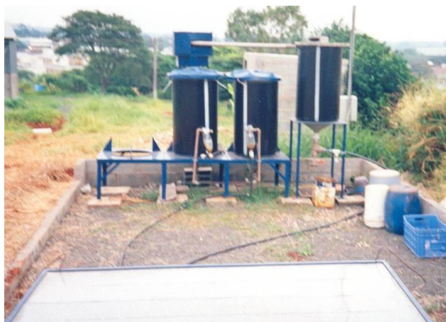
Fig. 2: Vista da estação de filtro lento da FEAGRI.
