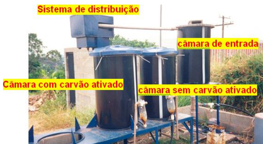
Fig. 5: Detalhe do conjunto de filtro lento.
