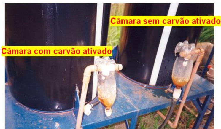
Fig. 6: Detalhe do conjunto de filtros lentos.
