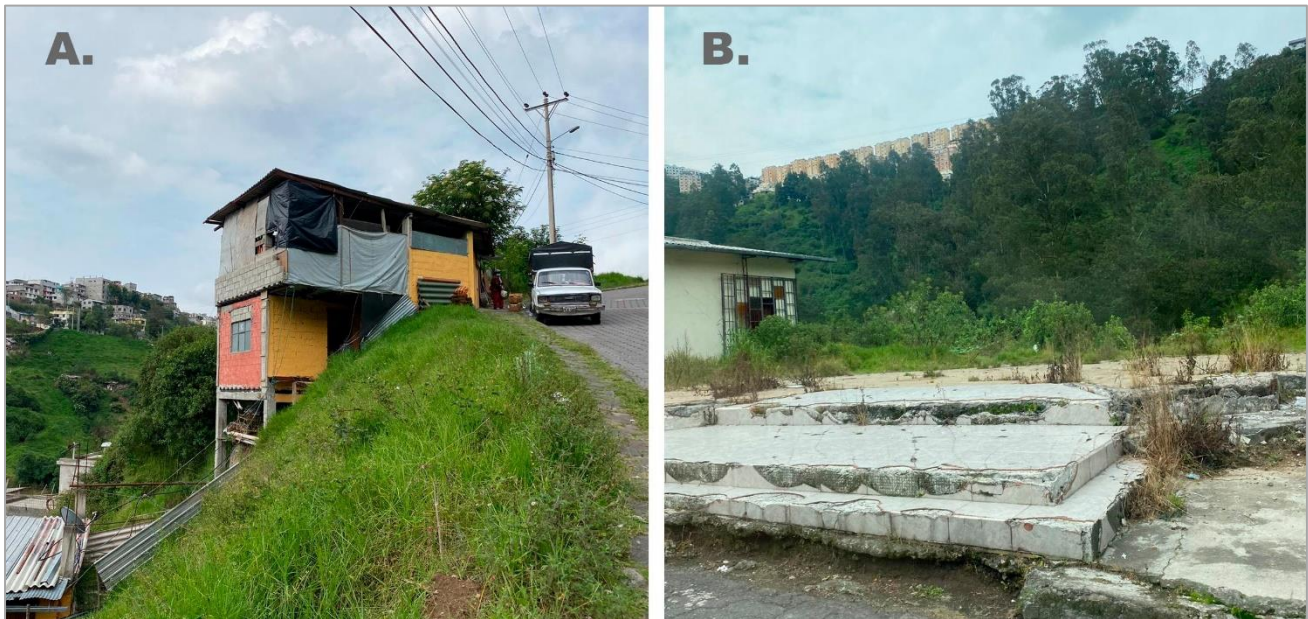
Fig. 13 (A) Estado físico de construcciones al borde de la Quebrada. Fuente: Propia del autor, (b) Restos de Iglesia colapsada
