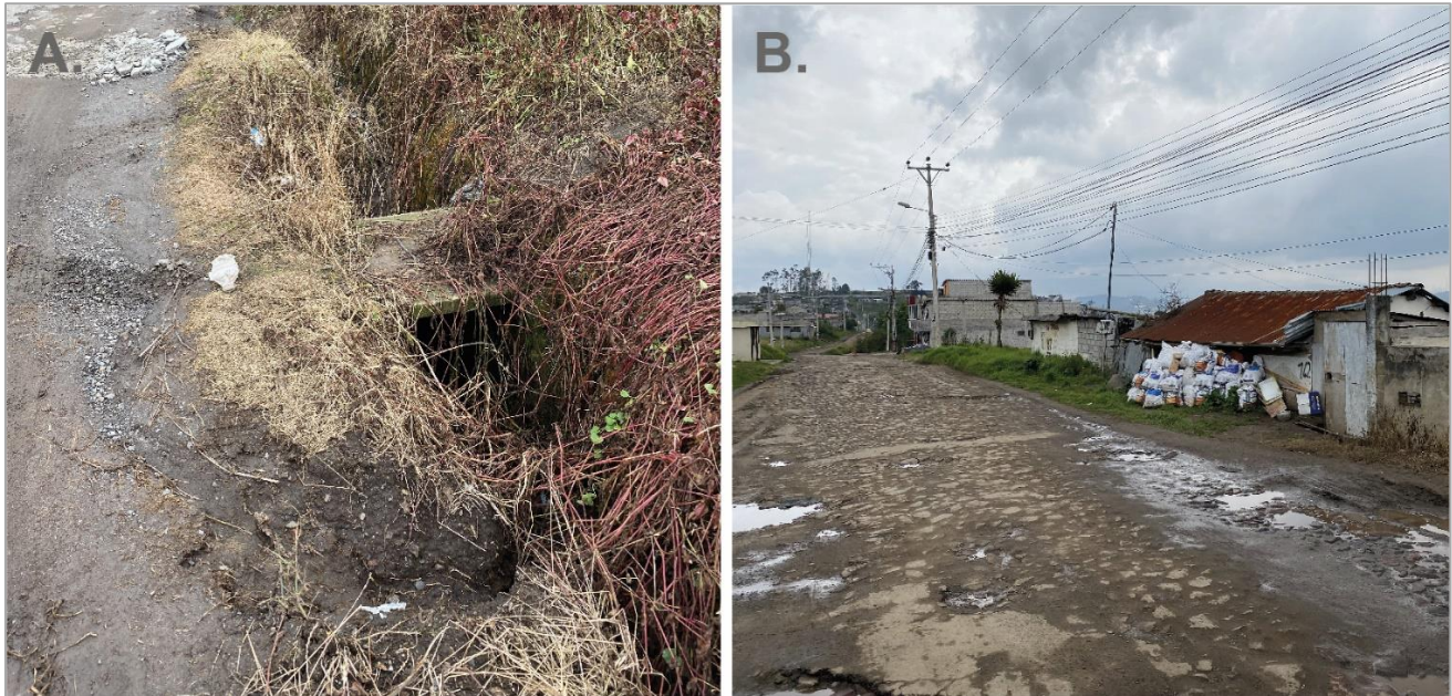
Fig. 05 Estado alarmante de la infraestructura vial. Fuente: Propia del autor
