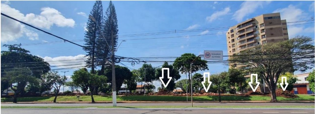
Fig. 3: Início das obras na Praça D. Pedro I em março de 2022 com terras deslocadas e acúmulo dos resíduos (terras e objetos daqueles que ali viviam), 2022 Fonte: Acervo da pesquisa, 2022
