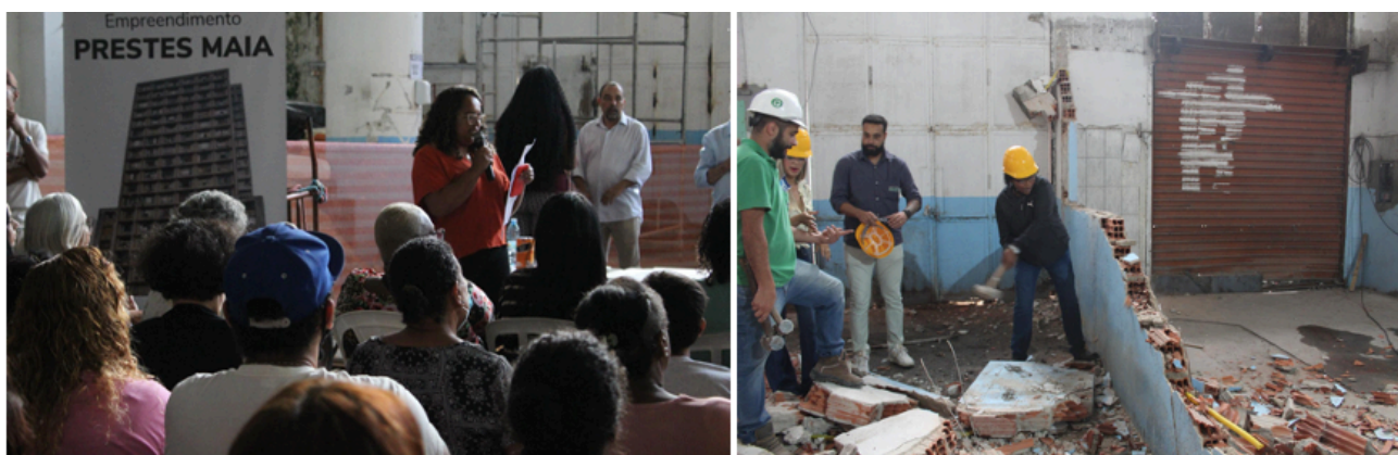
Fig. 11 e 12: dia da assinatura do contrato, ato simbólico início das obras do Edifício Prestes Maia (2022). Foto: site oficial FLM
