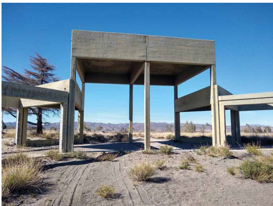
Fig. 7. Restos del Centro Cívico Villa Piedra del Águila. Fuente: Fernando Williams
