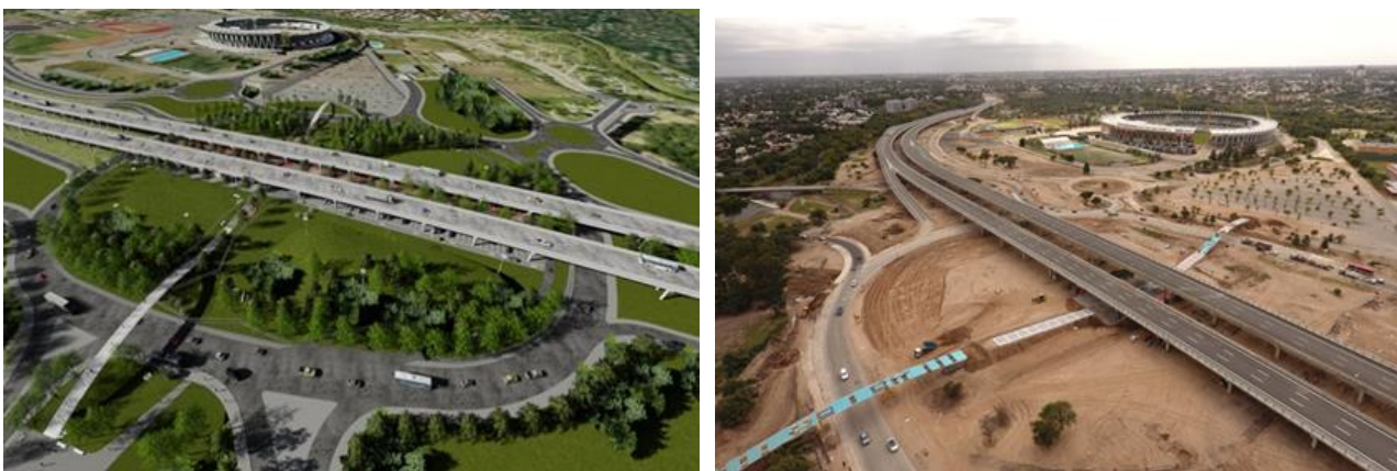
Fig. 4. Imágenes de la obra del viaducto sobreelevado en el tramo del Estadio Mario Alberto Kempes. Foto a, proyecto del área, foto b, obra en curso de la pasarela peatonal que atraviesa por debajo el viaducto conectando ambas margenes.
